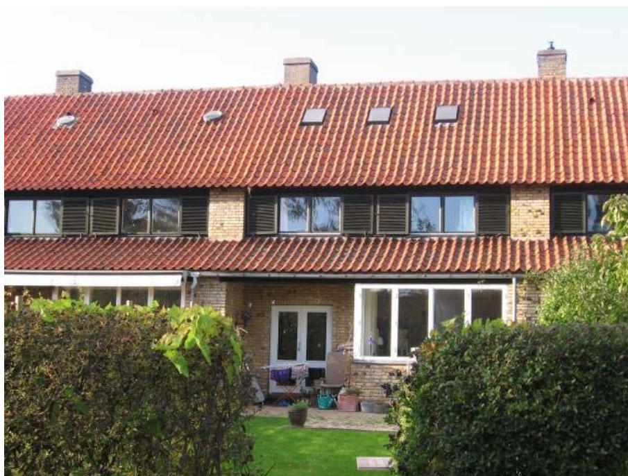
Billedtekst - Havesidens facade - bemærk 1. salens skodder og de manglende tagrender.
